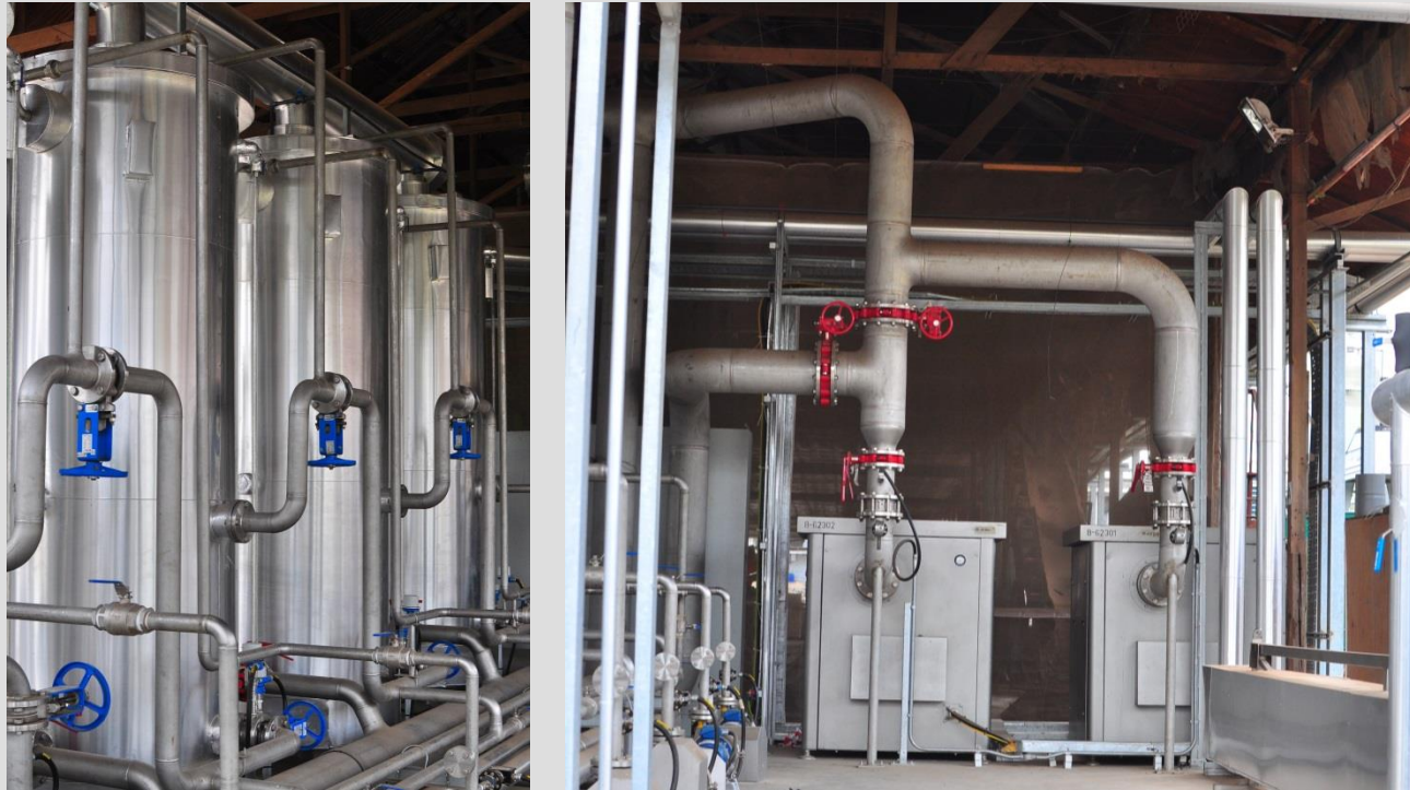
Area di strippaggio e soffianti per l'aria
