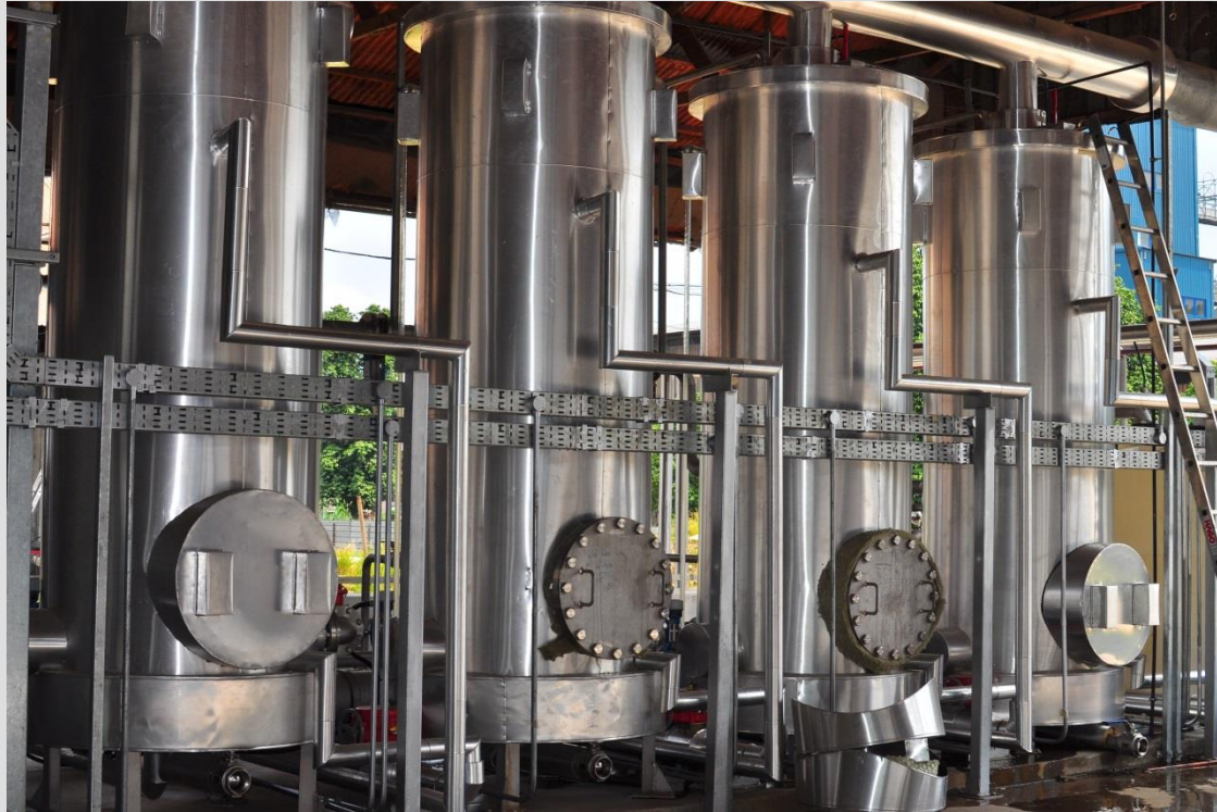
Torri di strippaggio
