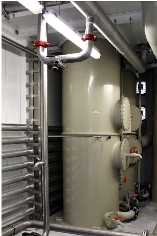
n. 2 scrubber per lavaggio aria
