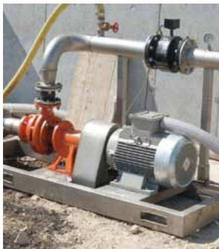
Figura 2 - Sistema iniezione del digestato
