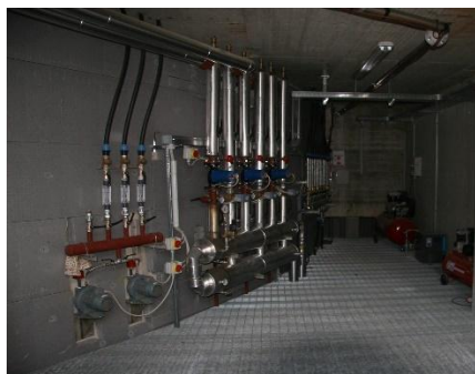
Tubazioni fluidiche per l'alimentazione con acqua calda cogenerata a servizio dell'impianto di Riscaldamento dei Fermentatori.
