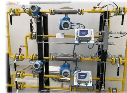
Cabina misura quantità e gestione dati
