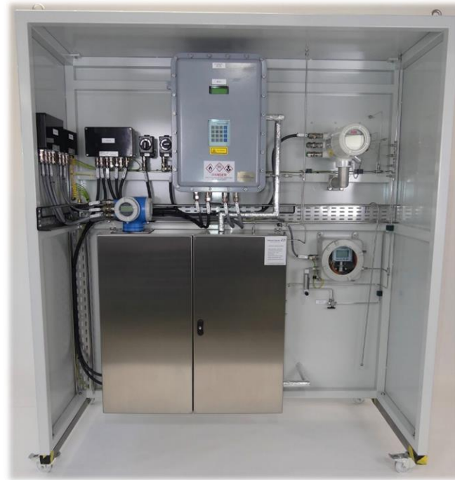
Skid di misura qualità
