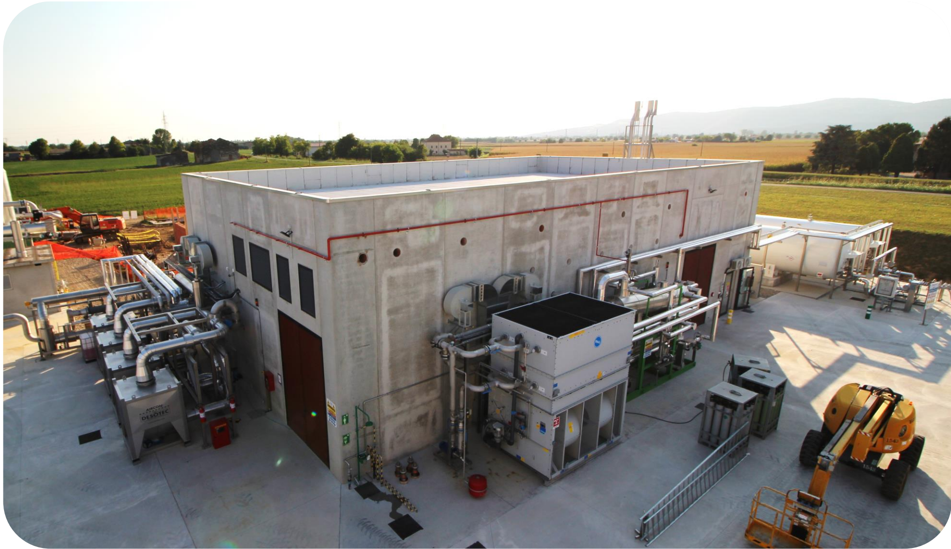
Installazione PENTAIR «BioComplete» 1.900 Nm 3 /h
