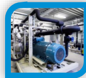
Sistema di Compressione (Recupero Calore)
