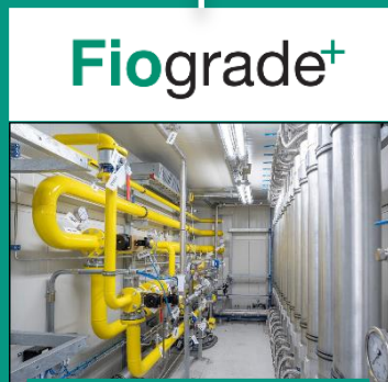
Impianto di upgrading
