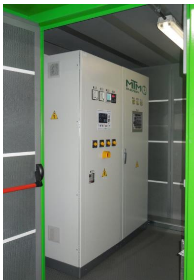
Quadro elettrico CHP + BIOLOGIA
