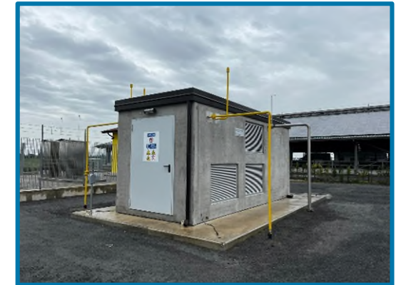
Cabina (Re.Mi di immissione in rete di trasporto o distribuzione )
