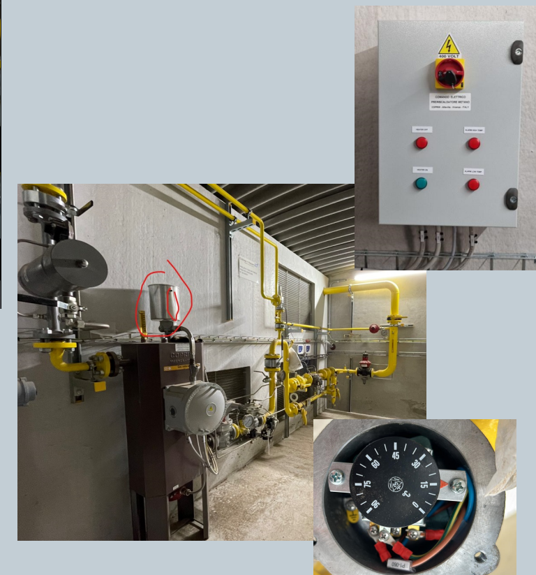
Verifica del funzionamento del gruppo di preriscaldamento
