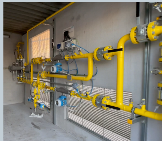
Scambio della linea di misura in funzione
